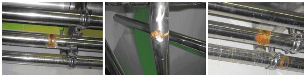
شکل ۲- خوردگی لوله ها پیرامون گرده جوش.
